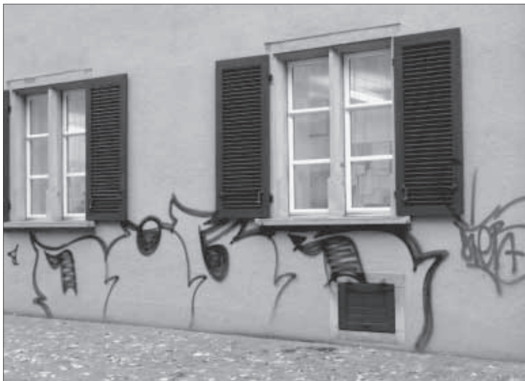
Das freut die Steuerzahler: Verunstaltete Fassade am renovierten Städtischen Altersheim an der Pfrundhausgasse.
