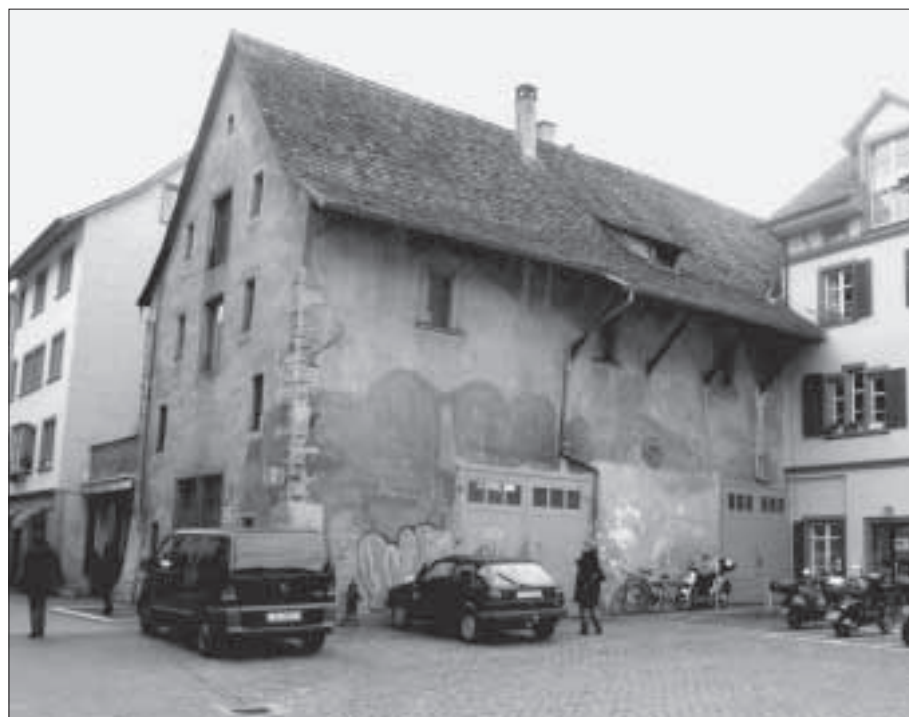
Renovation wäre sinnvoll: Das «Stadthaus-Geviert» ist in einem schitteren Zustand.
