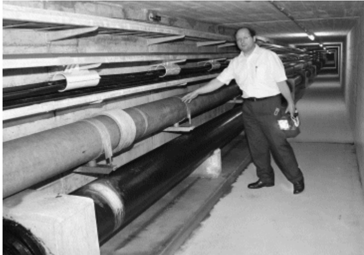
Bernhard von Felten erläutert die Funktion der Leitungen im Energiekanal.
