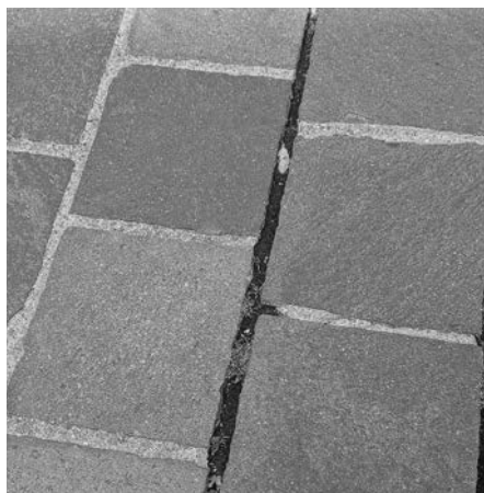
Risse: «Gut für die Schwammstadt, gefährlich mit dem Rollstuhl.»
